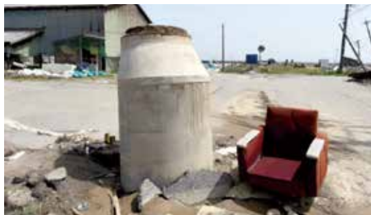
地震の影響で隆起したマンホール
